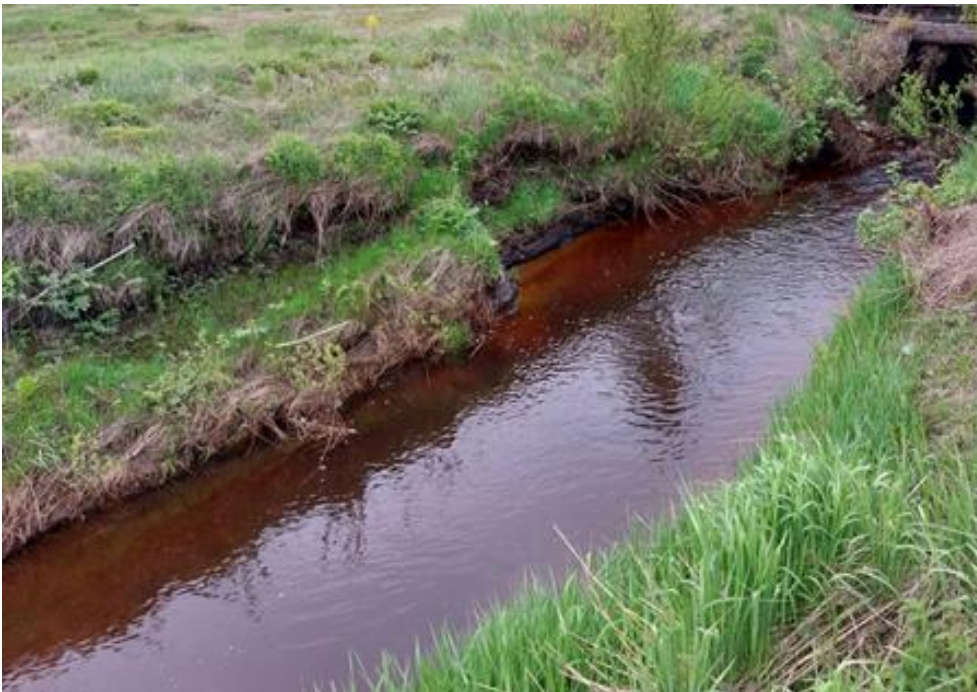
Kuva 32. Korkean veden aiheuttamaa syöpymää Porrasojan luiskassa.
